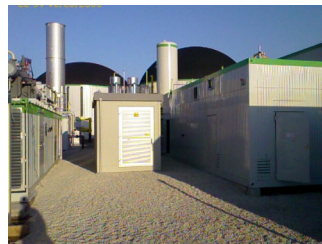
Gas-aufbereitung bei der Biomethananlage in Pliening. Foto: Ch. Boese
